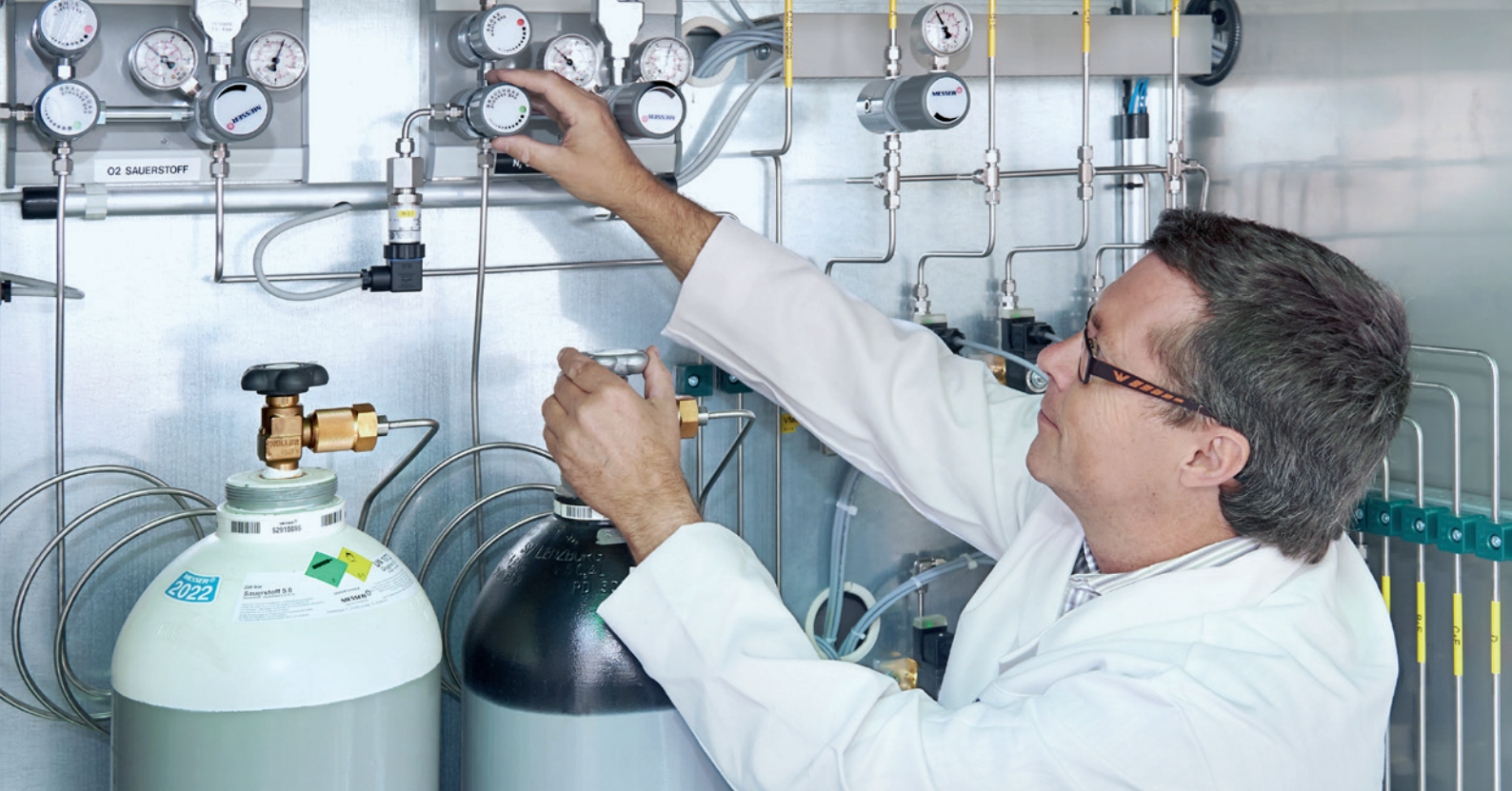
Sistema centralizado de suministro de gas
