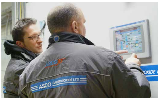
Durch regelmäßige Wartung sichern die ASCO Ingenieure den reibungslosen Betrieb der Anlage.
