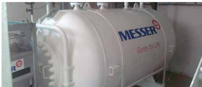
Obr. 5 - Skladování kapalného oxidu uhličitého
