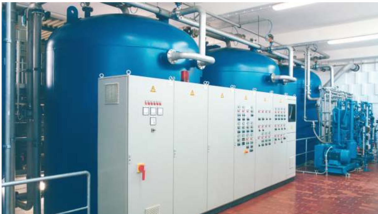
Obr. č. 8: Zařízení Carix® s kapacitou 3 000 m 3 za den.
