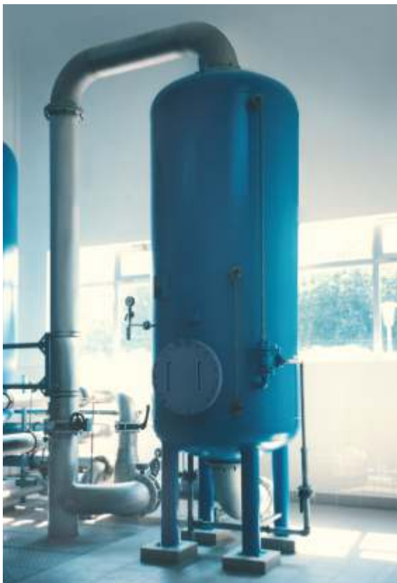
Obr. č. 9: Dávkování kyslíku pomocí „oxygenátoru“ pro oxidaci a separaci železa a manganu
