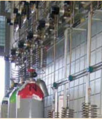
Zentrale Gasversorgung für Reinstgase.
