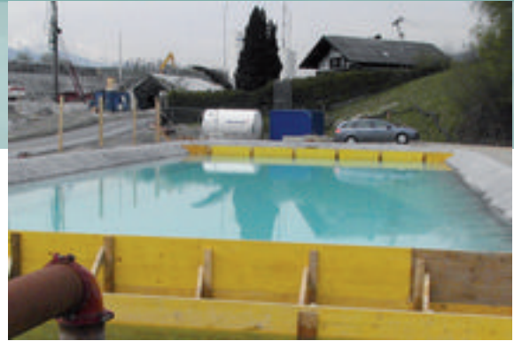
CO 2 -Speicherbehälter einer Baustellenneutralisationsanlage
