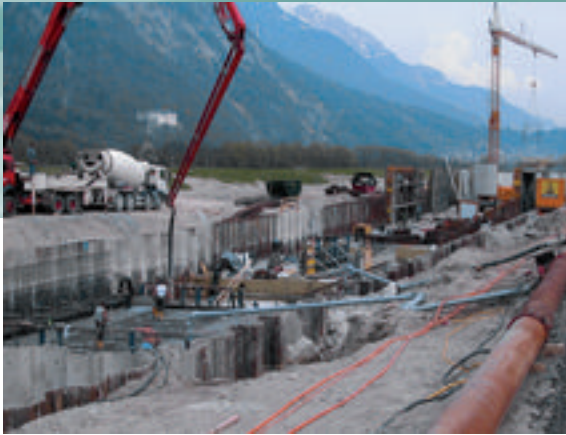
Rohrneutralisationsanlage auf einer Baustelle in Tirol
