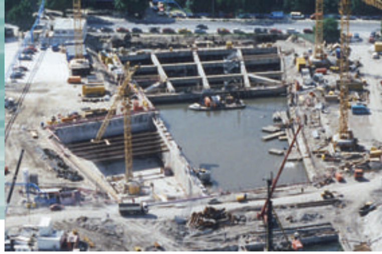
Kombination einer Vorneutralisation im Unterwasserbetonbecken mit einer Rohrneutralisationsanlage
