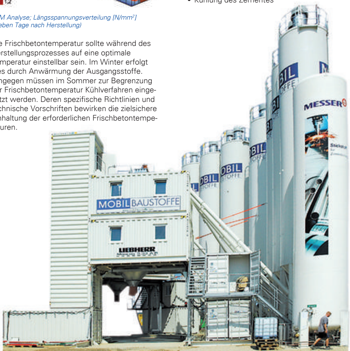
Zementkühlanlage auf einer Großbau- stelle bei Wien
